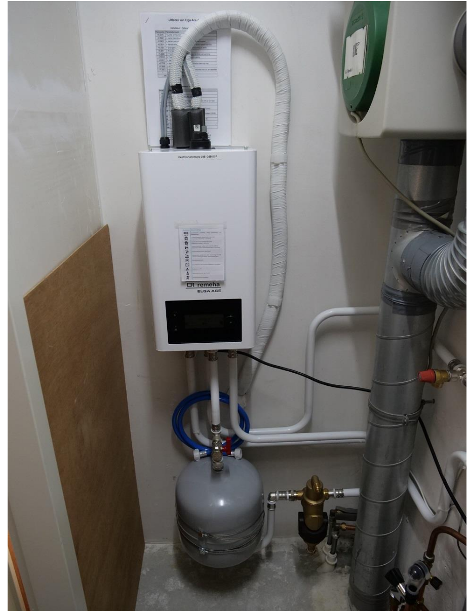
Binnendeel van Elga Ace 4kW met buffervat en vuilfilter/ontluchter
